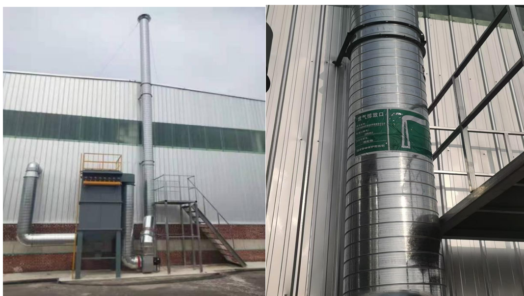
图 3-2 布袋除尘器+15m 排气筒
